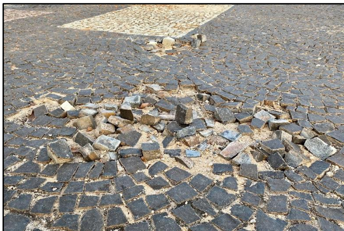
Figura 39 – Pedras soltas do pavimento da Praça.
