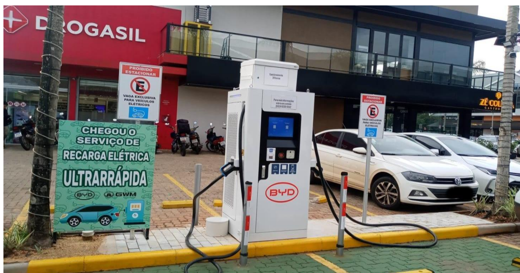
Figura 15 - Posto de Carregamento Rápido BYD, localizado na quadra 208 sul, em Palmas/TO.
