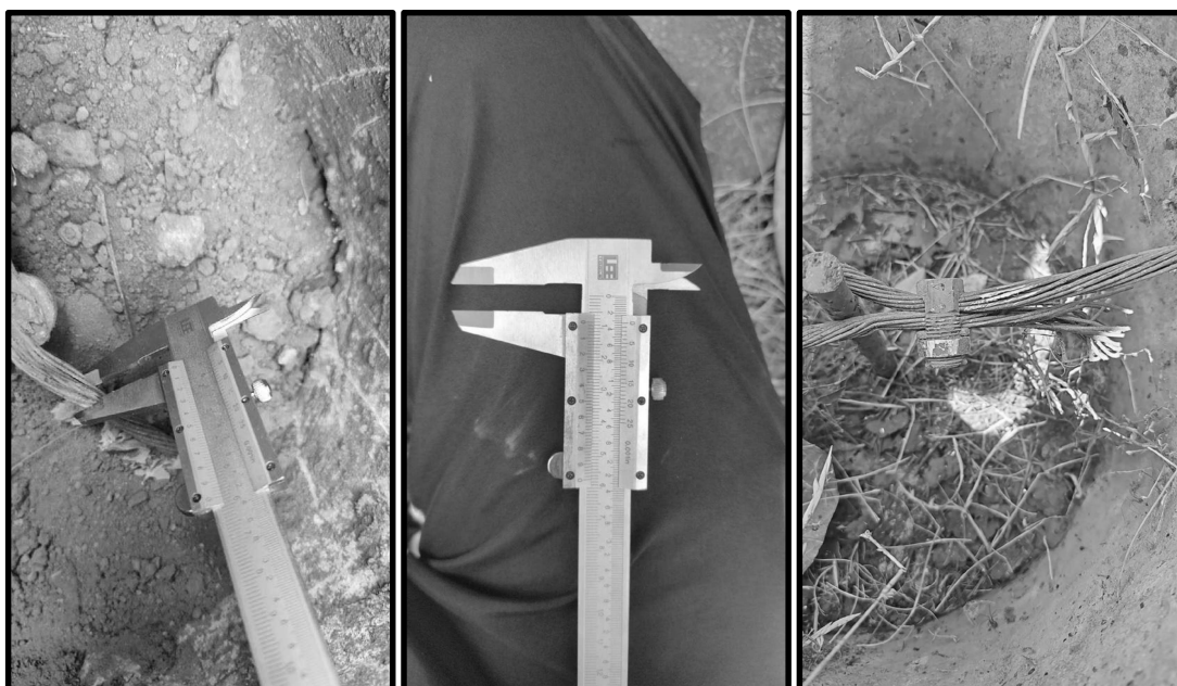
Figura 33 a 35 - Cordoalha do anel de aterramento
