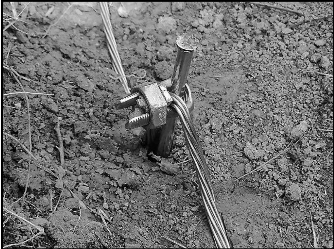
Figura 10 - Haste de aterramento
