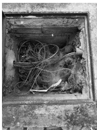
Figura 7 - Caixa de passagem completamente abandonada
