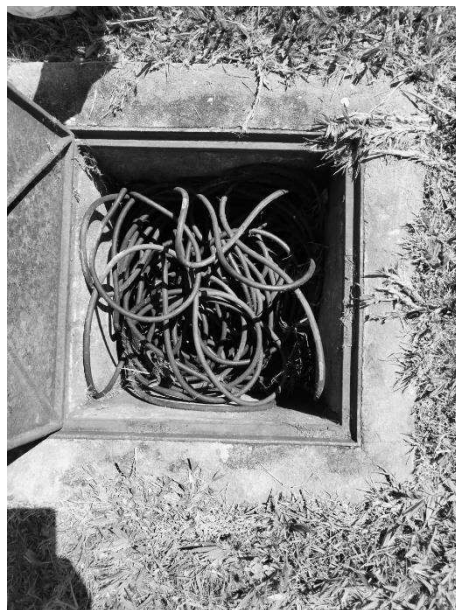
Figura 9 - Caixa de passagem pequena
