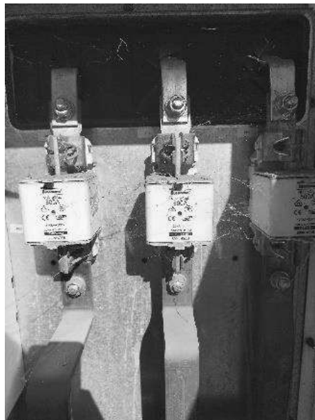
Figura 3 - Fusíveis do gerador
