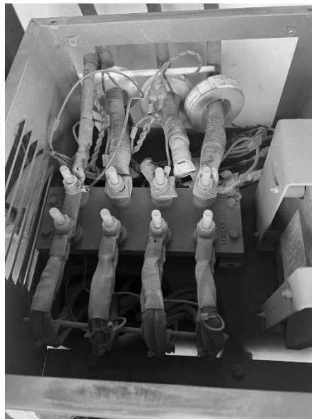
Figura 5 - Fase rompida no gerador
