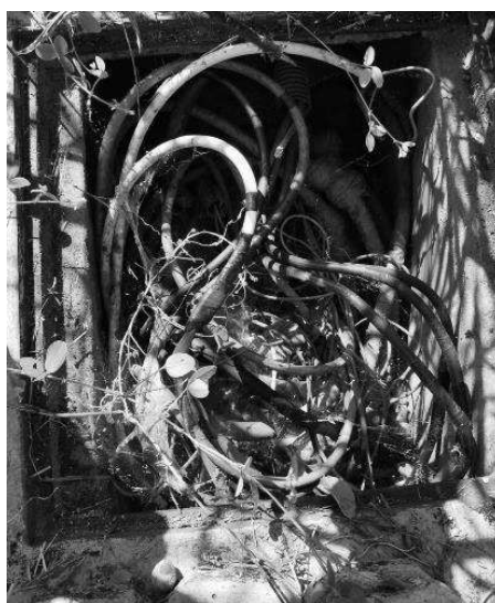
Figura 11 - Caixa de passagem com vegetação
