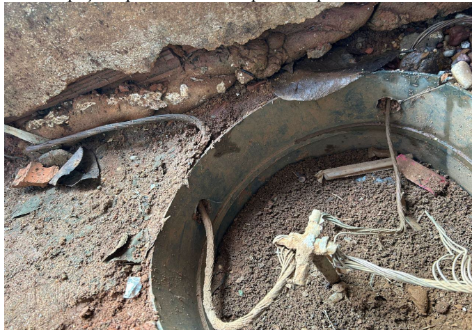
Figura 38 - Caixa de inspeção tipo solo com rompimento parcial e condutor exposto (bloco 16).
