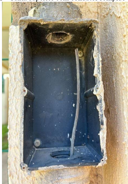
Figura 36 - Caixa superior com condutor rompido (bloco 16).
