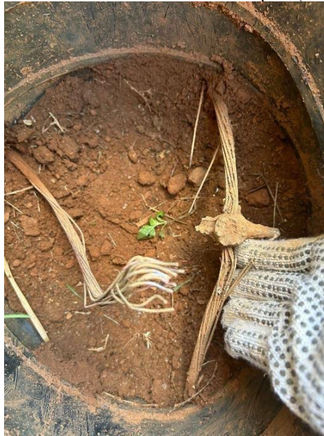
Figura 37 - Conexão de aterramento rompida (bloco 14).
