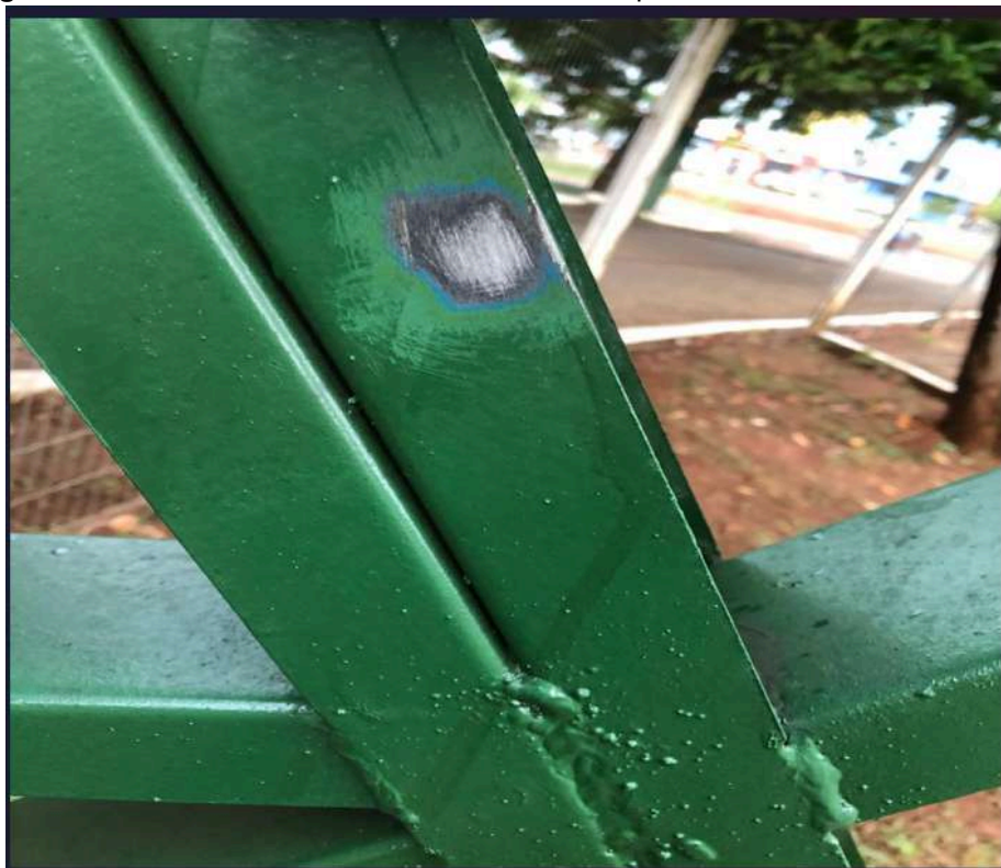
Figura 35 - Evidência das várias camadas de tinta presentes na estrutura metálica
