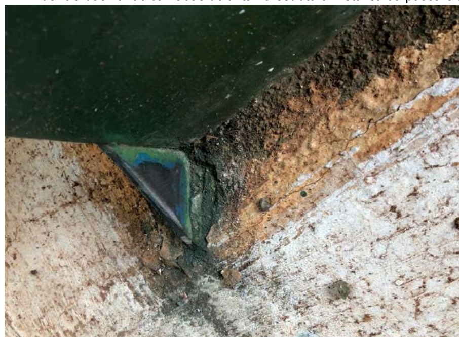
Figura 37 - Evidência das várias camadas de tinta na estrutura metálica da passarela coberta.
