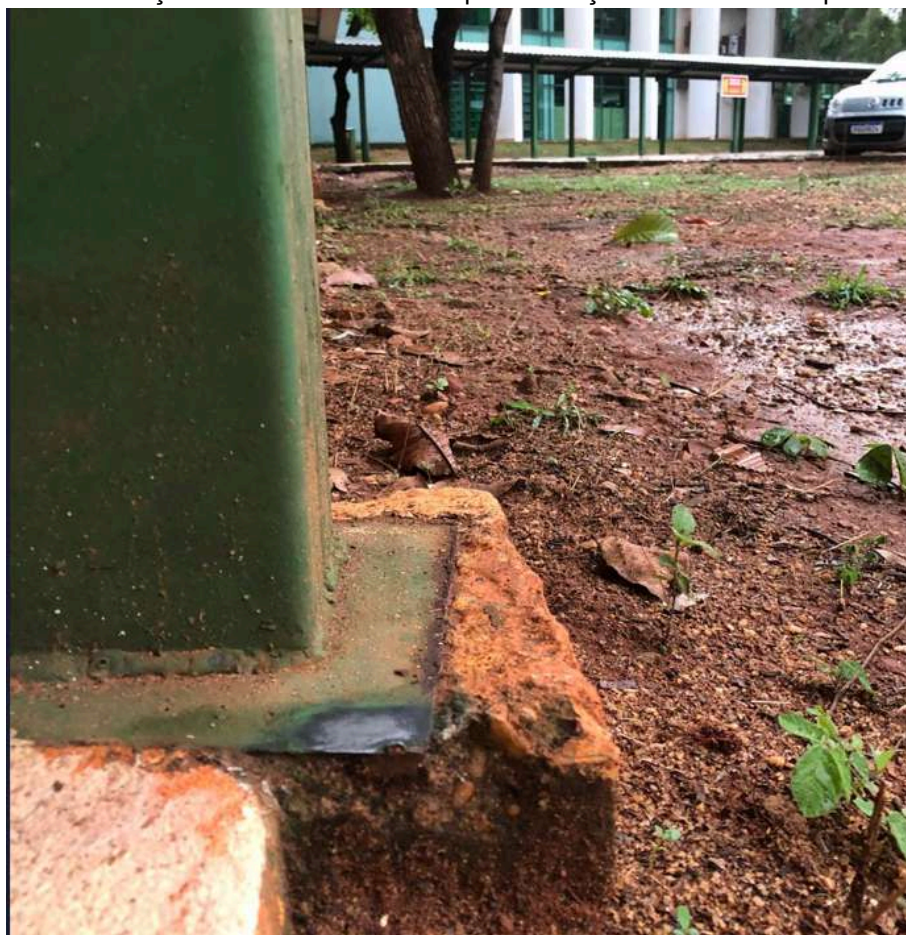
Figura 36 - Atual condição da base metálica de apoio e fixação da estrutura da passarela coberta.
