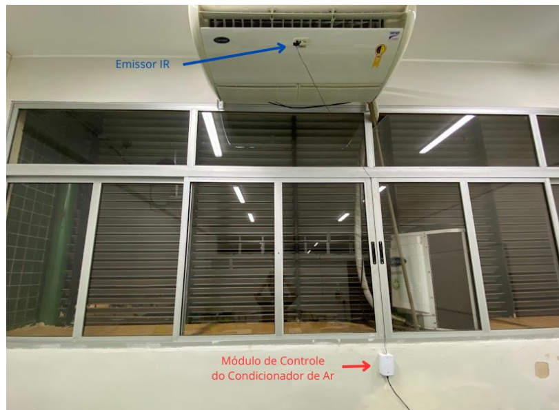
Figura 35: Posicionamento do emissor infravermelho no condicionador de ar
