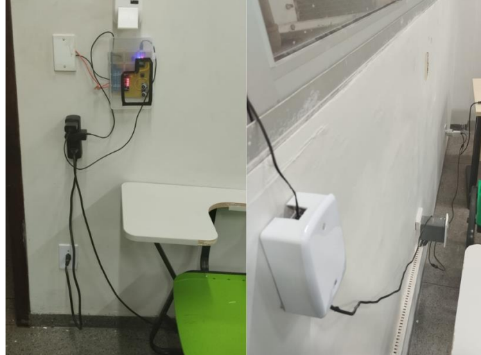
Figura 37: Posicionamento dos Sistemas de Controle da Iluminação e do Condicionador de Ar
