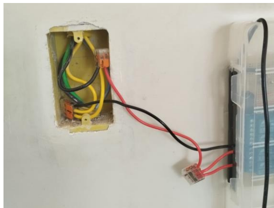
Figura 34: Adaptação realizada frente ao problema com os relés
