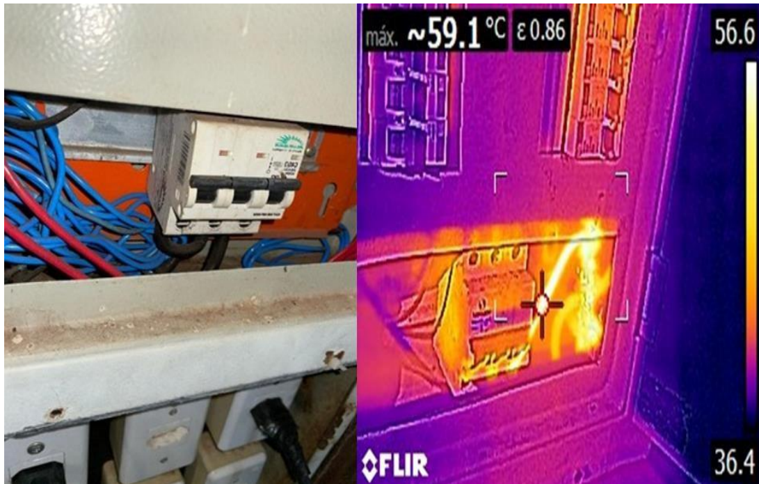
Figura 14 - Detecção de pontos quentes nos quadros de distribuição.
