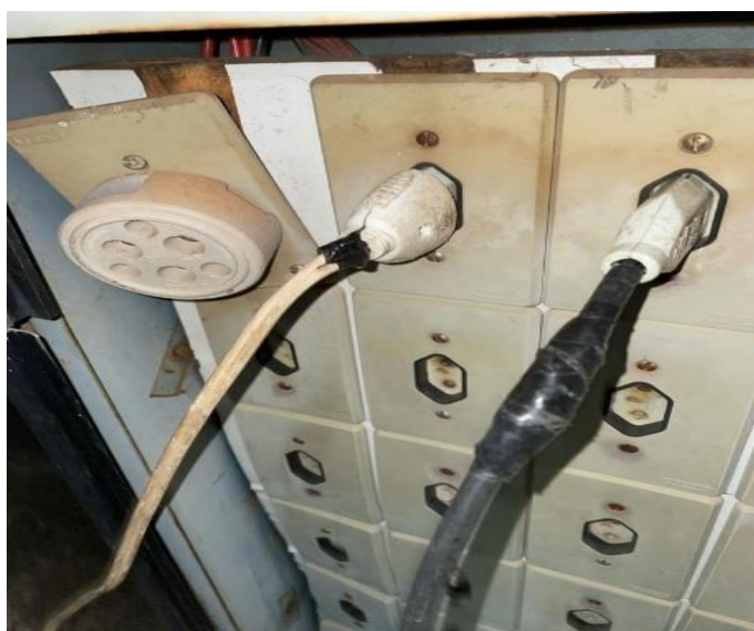
Figura 12 - Uso de extensões elétricas não embutidas expostas ao ambiente.
