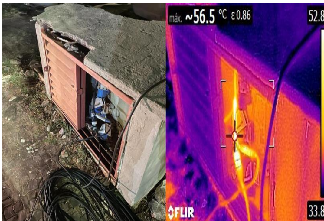
Figura 13 - Detecção de pontos quentes nas extensões.
