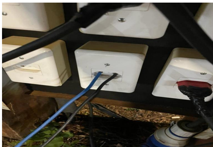
Figura 15 - Conexões inseridas diretamente nas tomadas de corrente.
