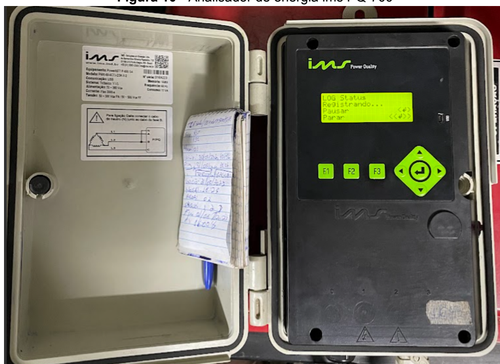
Figura 10 - Analisador de energia ims PQ-700
