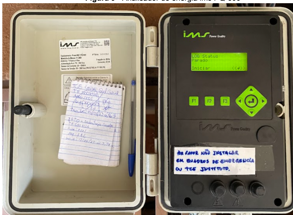
Figura 9 - Analisador de energia ims PQ-600
