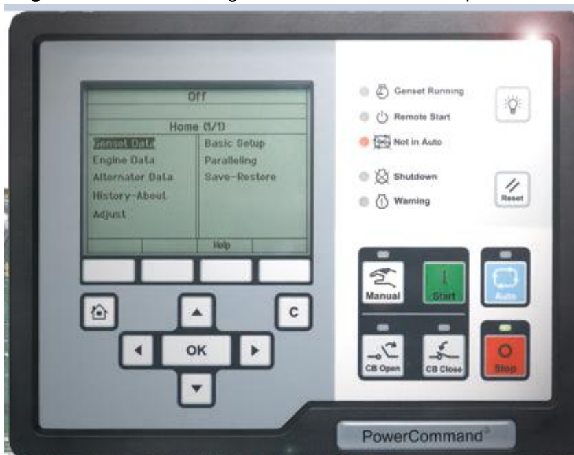
Figura 8 - Controlador do gerador DCCO do IFTO Campus - Palmas
