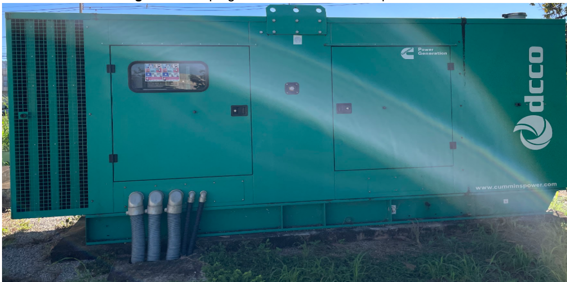
Figura 6 - Grupo gerador instalado no Campus Palmas
