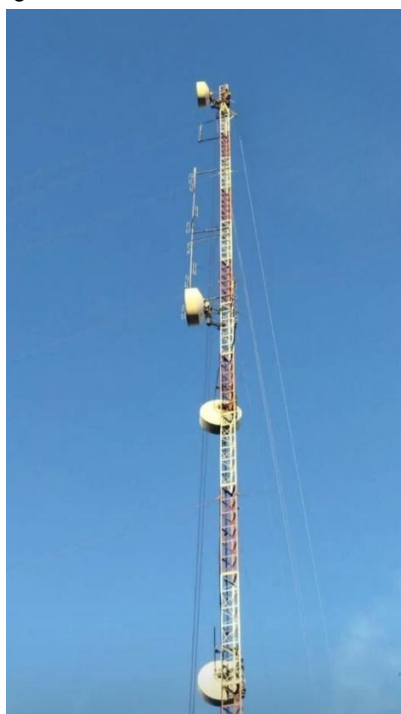
Figura 23 - Antena de telecomunicação
