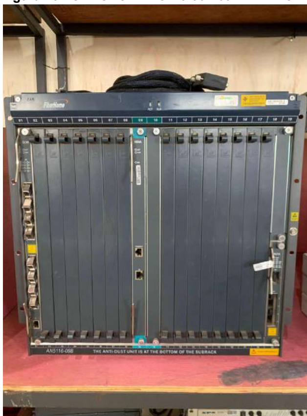
Figura 20 - OLT GPON AN5116-06B da FIBERHOME
