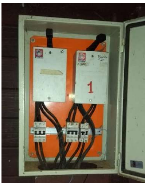
Figura 33 – Chave de comutação entre as fontes geradoras do CPC.
