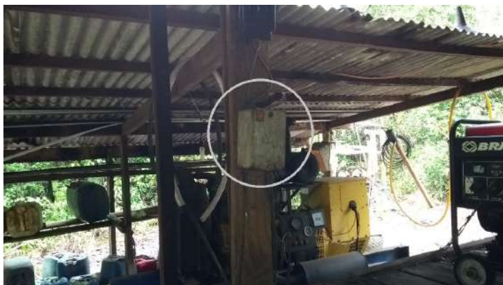
Figura 32 – Chave de comutação manual de intercanbiação dos geradores
