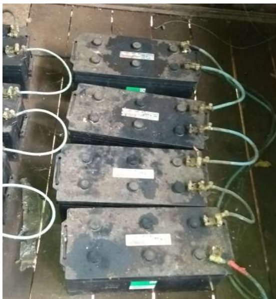
Figura 28 – Banco de baterias em má estado de conservação
