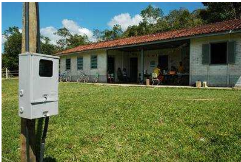
Figura 10 - Instalações em escolas na zona Rural
