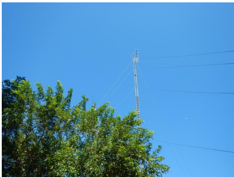
Figura 26 - Proteção contra descargas atmosféricas no CPC – para-raios tipo Franklin
