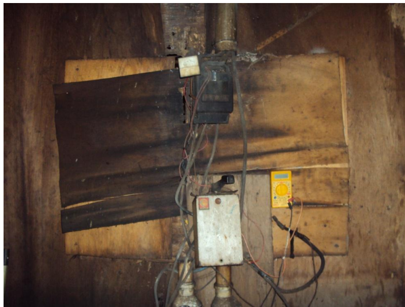
Figura 25 - Proteção da fonte geradora a diesel
