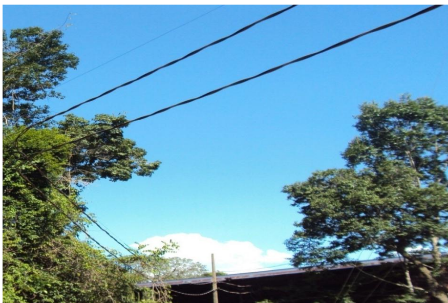
Figura 22 - Cabos para distribuição de energia no CPC
