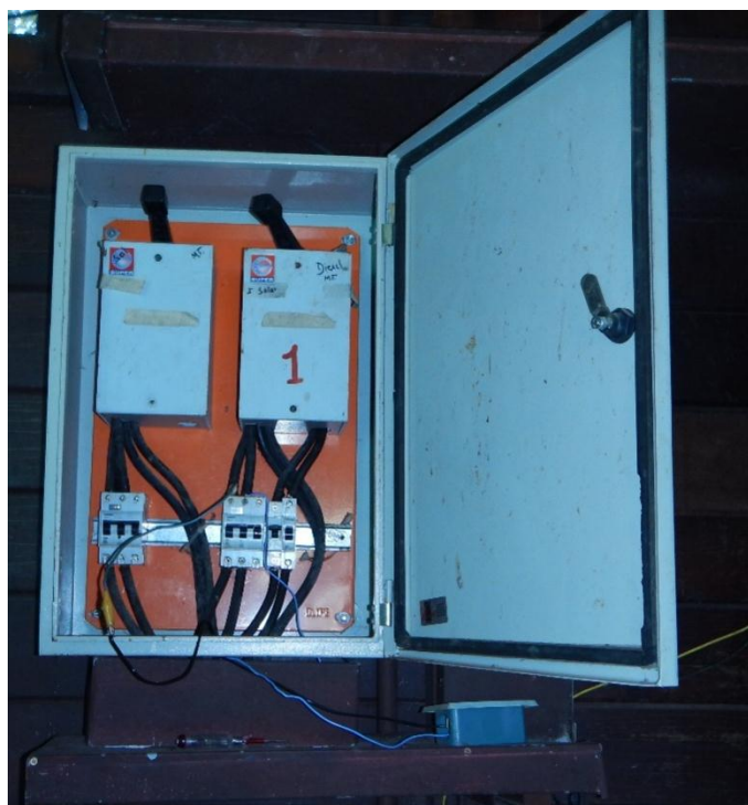
Figura 24 - Quadro de controle para chaveamento entre fontes
