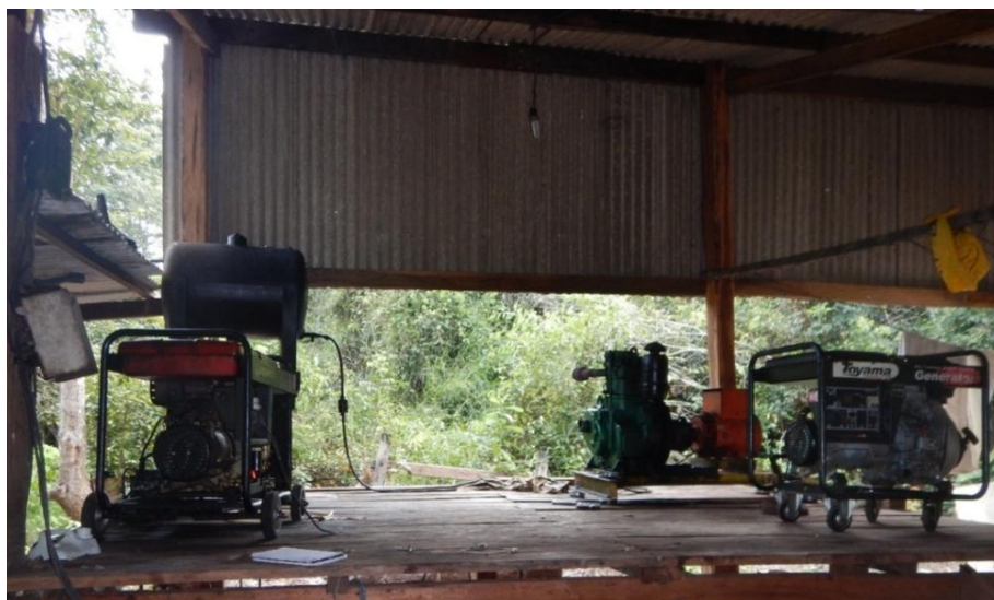
Figura 17 – Conjunto de geradores a diesel do CPC
