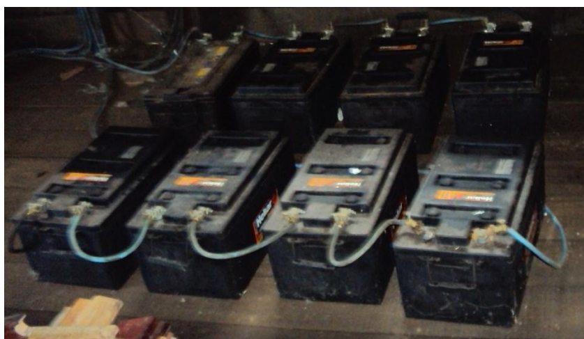
Figura 14 - Banco de Baterias
