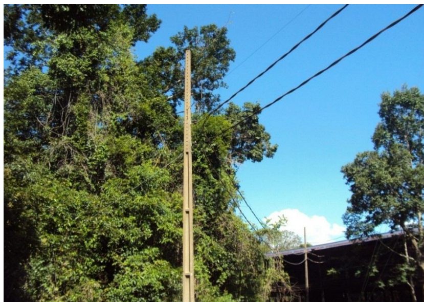
Figura 21 - Rede de distribuição de energia elétrica no CPC
