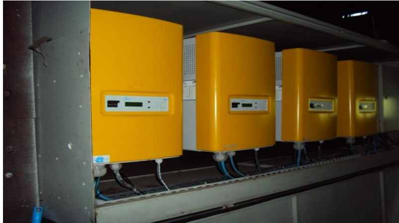
Figura 12 - Inversores de corrente contínua em alternada
