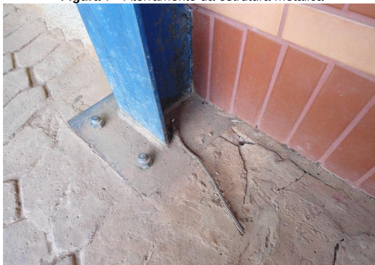
Figura 7 - Aterramento da estrutura metálica
