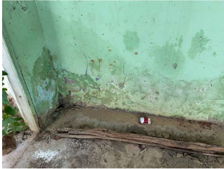
Figura 38 - Umidade ascendente – Refeitório.
