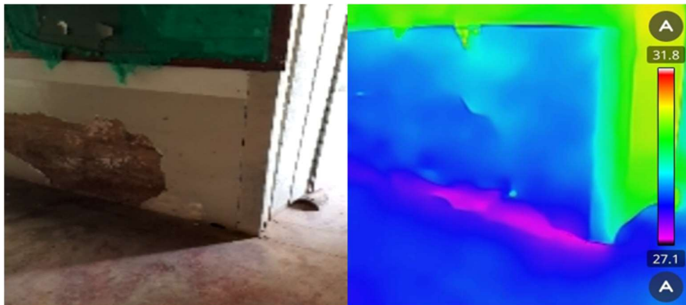
Figura 9 - Análise termográfica - Hall.
