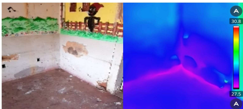
Figura 10 - Análise termográfica - Sala/Peti.
