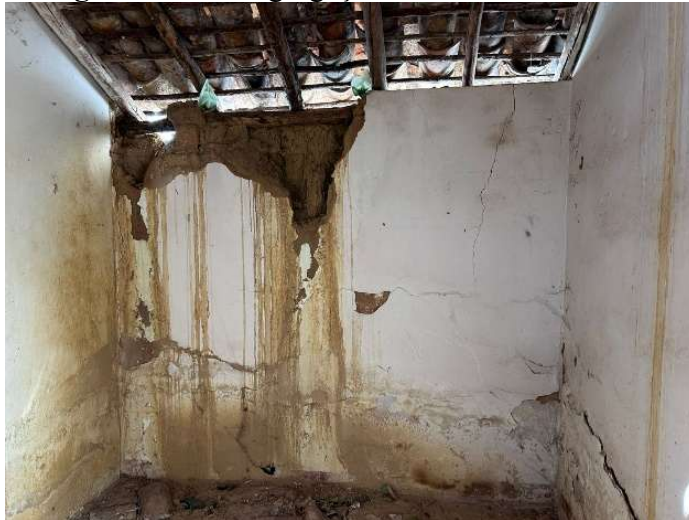
Figura 23 - Desagregação ou erosão - Cozinha.
