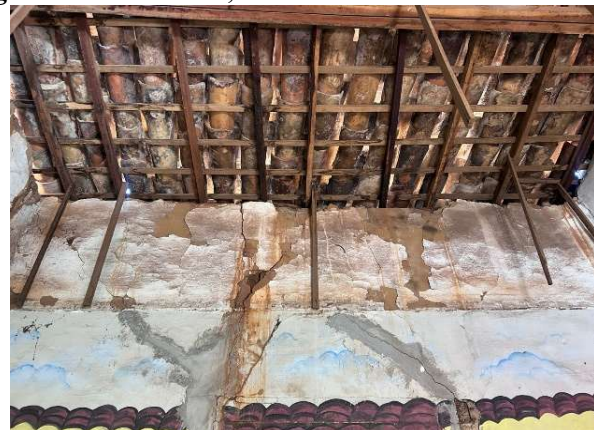
Figura 30 - Fissuras, trincas e rachaduras - Sala/Peti.
