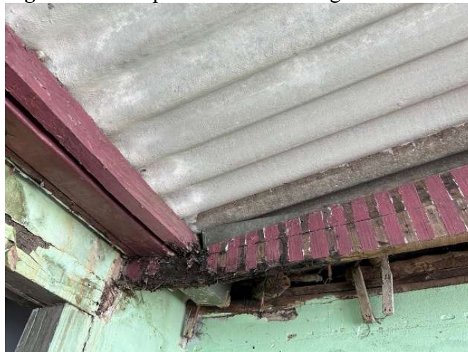
Figura 16 - Ataque de insetos xilófagos - Refeitório.
