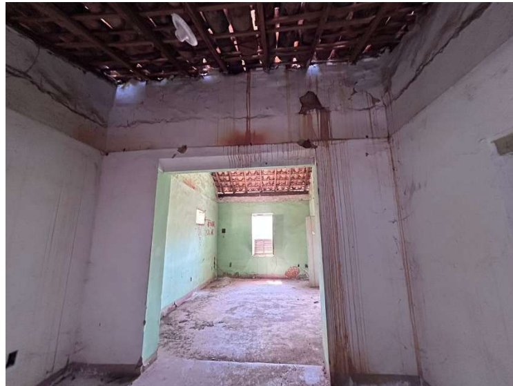
Figura 39 - Umidade descendente - Sala 2.
