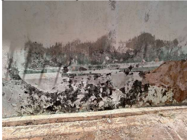
Figura 20 - Crosta negra ou sujidades – Fachada leste.
