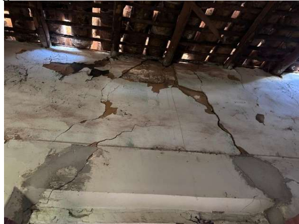
Figura 29 - Fissuras, trincas e rachaduras - Atelier.
