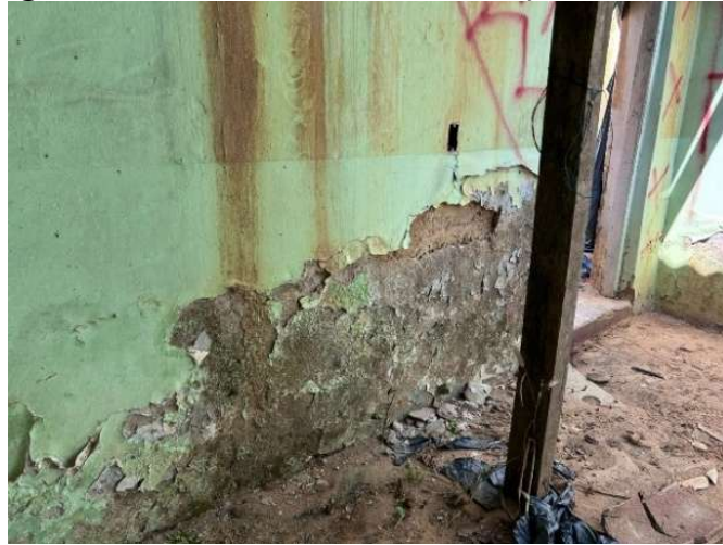
Figura 25 - Descascamento ou esfoliação - Refeitório.
