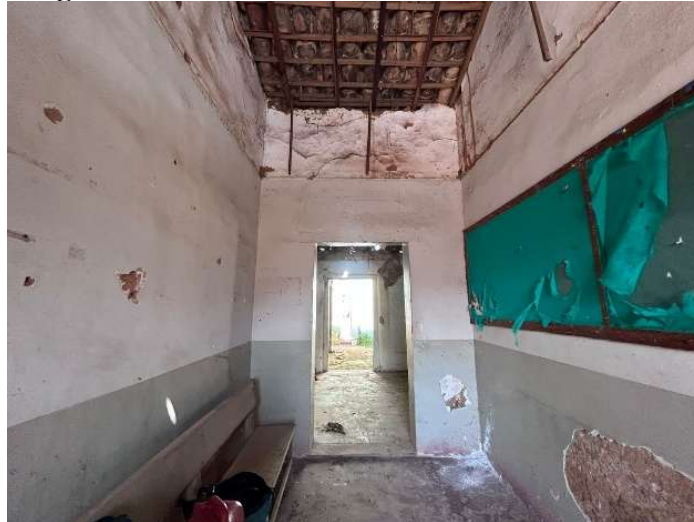
Figura 27 - Descolamento ou destacamento - Hall.
