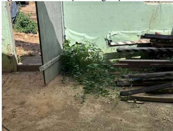
Figura 37 - Presença de vegetação - Refeitório.
