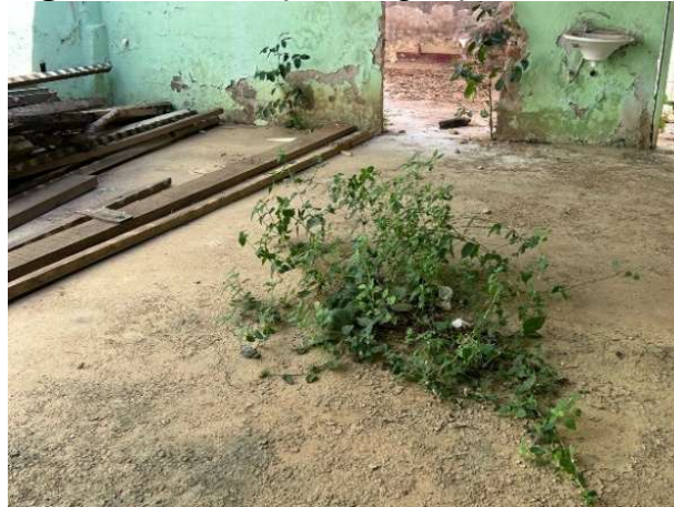
Figura 36 - Presença de vegetação - Refeitório.
