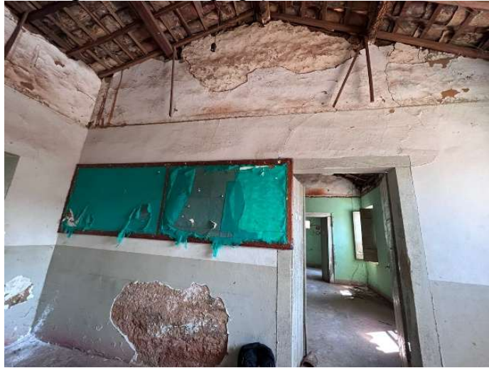
Figura 22 - Desagregação ou erosão - Hall.
