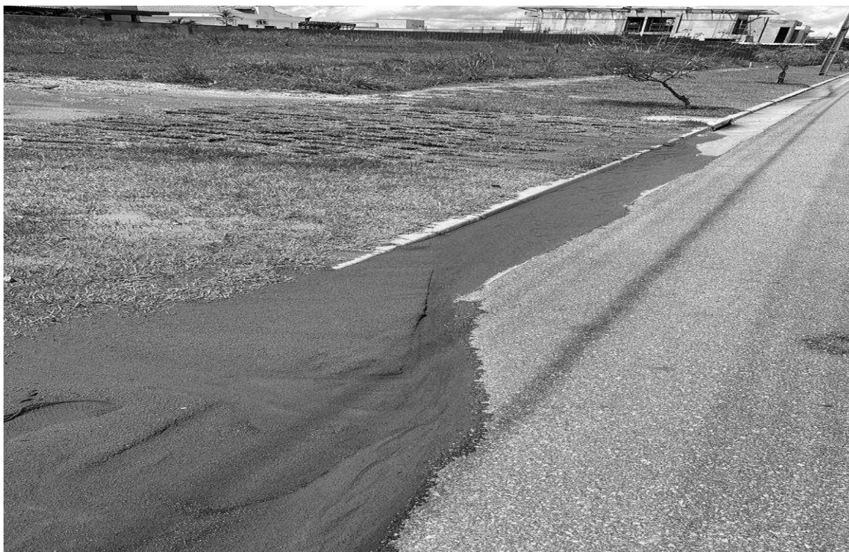
Figura 4: Acúmulo de terra na sarjeta impossibilitando a drenagem de água pluvial
