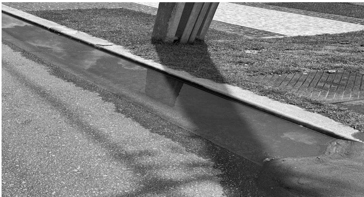
Figura 2: Má drenagem causada pelo acúmulo de terra vinda do lote de apoio.
