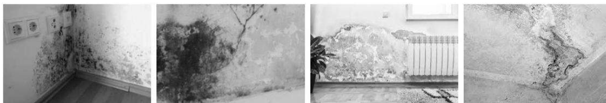
Figura 4 – Parede com mofo e bolor.
