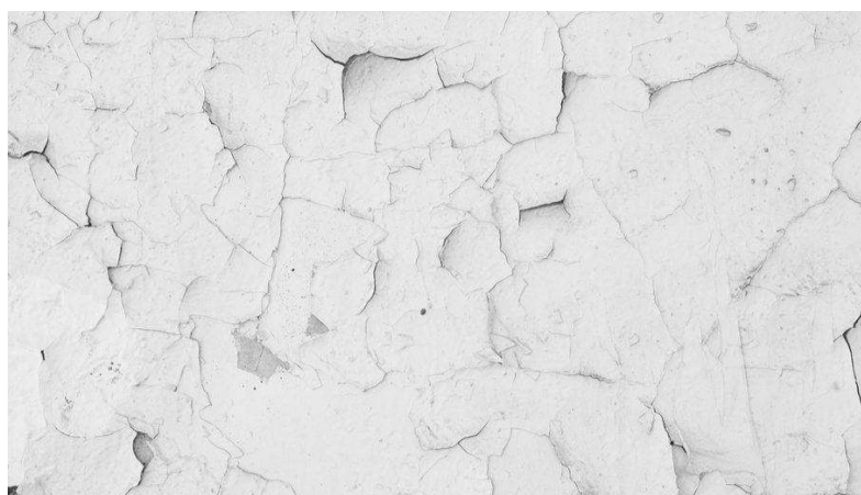
Figura 11 – Patologia na pintura: Descascamento.
