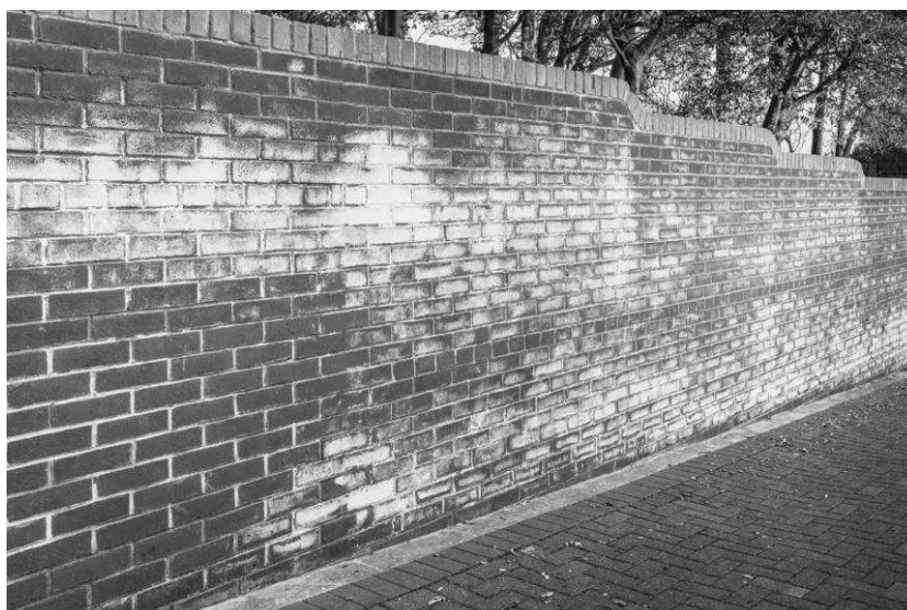
Figura 5 – Eflorescência em muro de tijolinhos.
