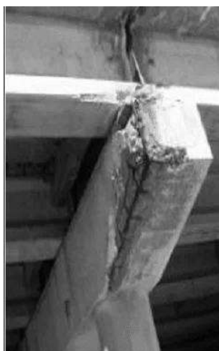
Figura 6: Armadura exposta pelo deslocamento do concreto.
