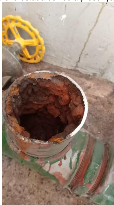
Figura 1 - Tubulação encrustada devido a presença de ferro e manganês.
