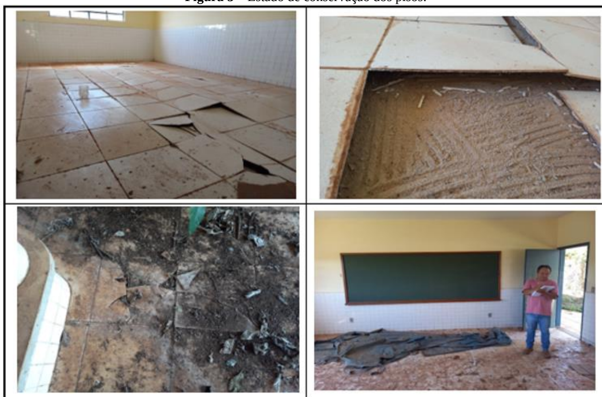
Figura 5 – Estado de conservação dos pisos.
