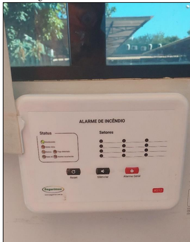
Figura 5 - Central de alarme de incêndio
