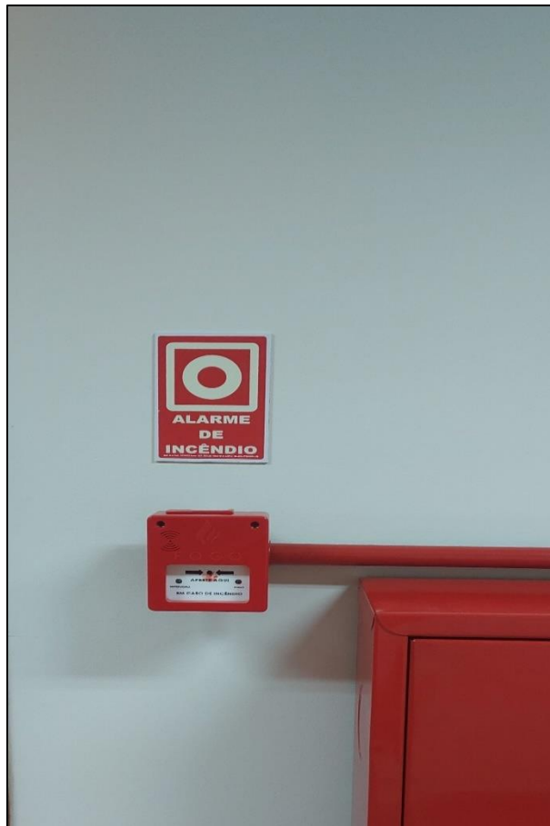
Figura 6 - Botoeira de alarme de incêndio
