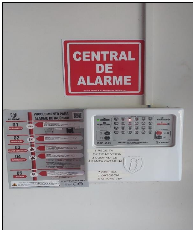
Figura 34 - Central de alarme com sirene desligada indicando falso alarme de incêndio
