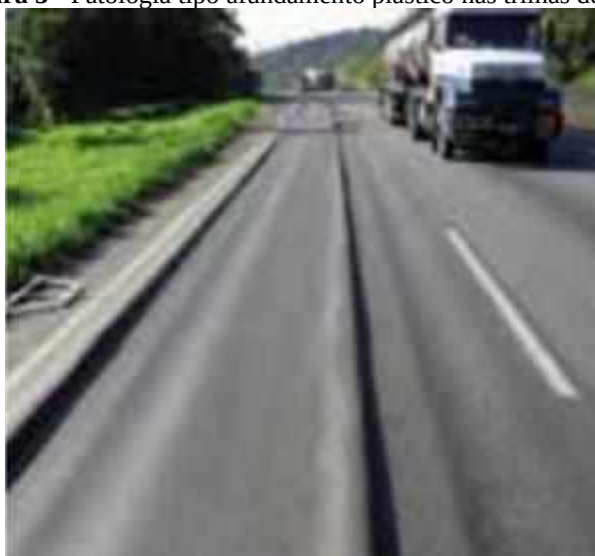
Figura 3 - Patologia tipo afundamento plástico nas trilhas de roda
