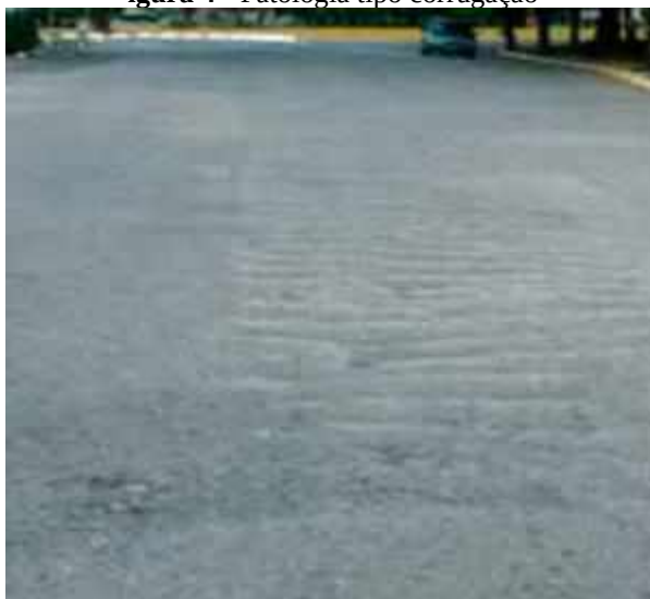
Figura 4 - Patologia tipo corrugação
