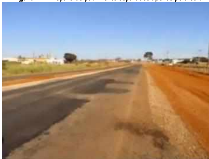
Figura 12 - Reparo de pavimento separados apenas pela cor.
