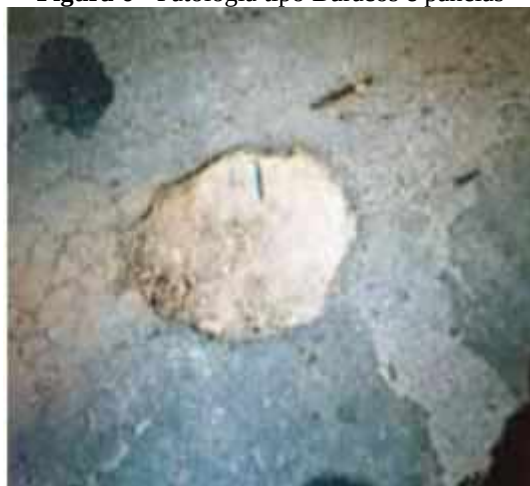
Figura 6 - Patologia tipo Buracos e panelas
