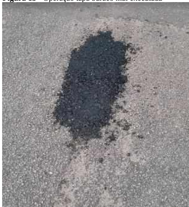
Figura 15 - Operação tapa buraco mal executada
