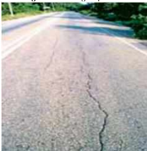
Figura 2 - Patologia tipo trinca
