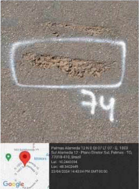
Figura 18 - Novos buracos que surgiram na alameda 12 da 1003 sul
