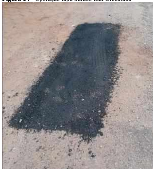
Figura 14 - Operação tapa buraco mal executada
