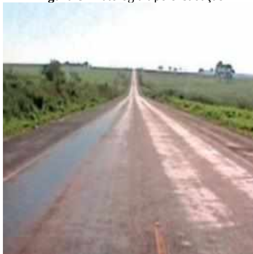
Figura 8 - Patologia tipo exsudação
