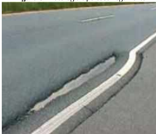
Figura 5 - Patologia tipo escorregamento
