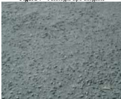
Figura 7 - Patologia tipo desgaste
