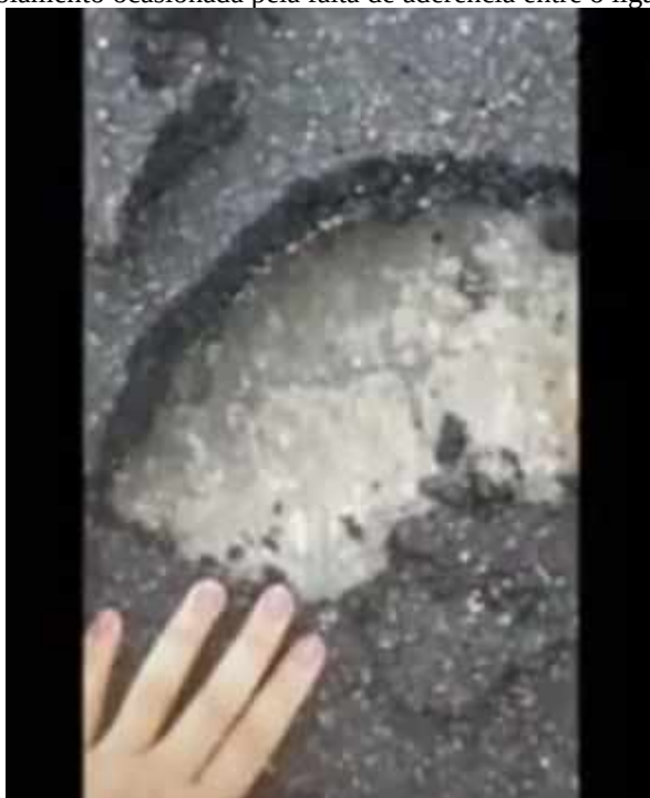
Figura 11 - Patologia de descolamento ocasionada pela falta de aderência entre o ligante e a massa asfáltica
