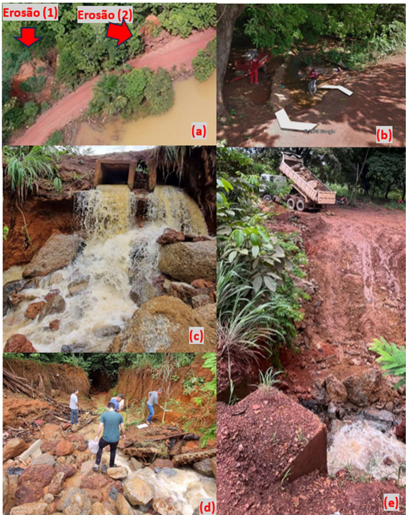
Figura 3.1 pontos de erosão 1 e 2 (a), o registro da árvore antes da erosão (b) no ponto 1 frente ao extravasor (c), lançamento de blocos de rocha para conter a erosão (d) e retirada de amostras para análise no ponto 1 (e). Fonte: Pereira et al. (2024)
