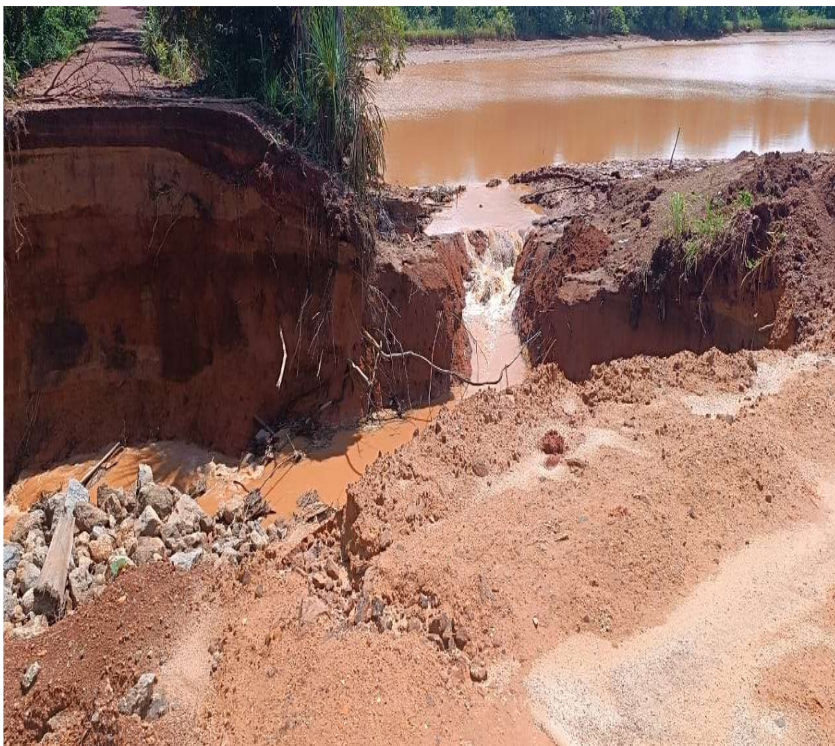
Figura 4.14 – Mostra o rompimento do talude e a falha da barragem no ponto de erosão 1. Fonte: Pereira et al. (2024)
