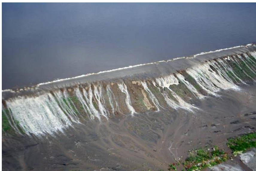
Figura 25 – Barragem de aterro galgada.
