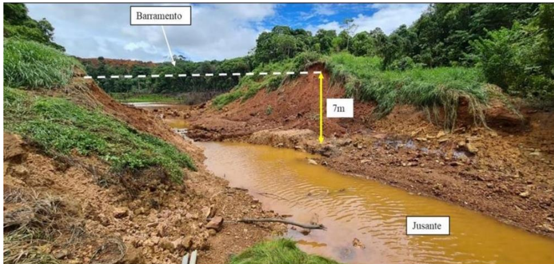
Figura 20 – Barragem do Pirocaua após galgamento.
