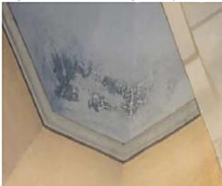
Figura 4 - Manchas de umidade por infiltração em forro
