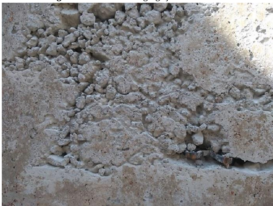
Figura 15 – Ninhos e segregações no concreto
