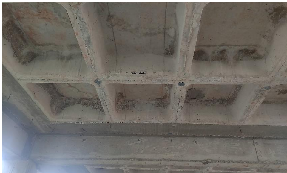
Figura 42 - Trincas em laje
