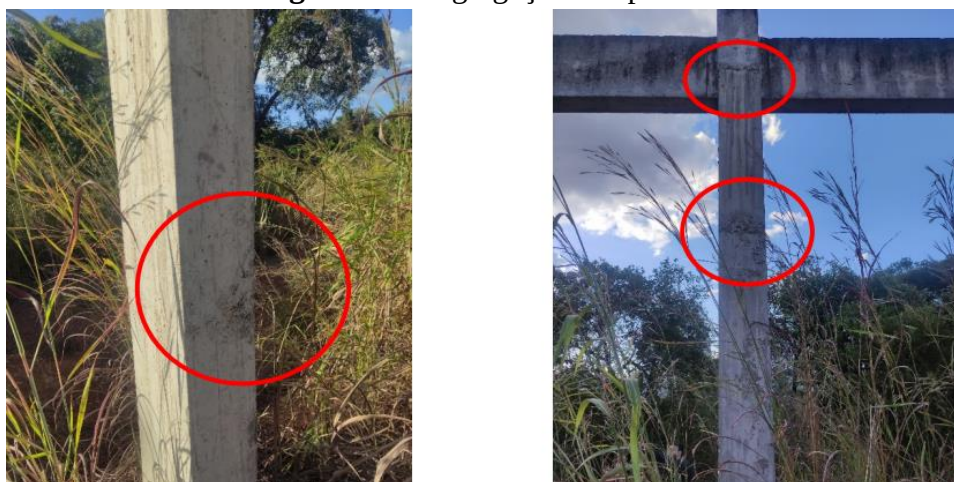
Figura 29 - Segregação nos pilares
