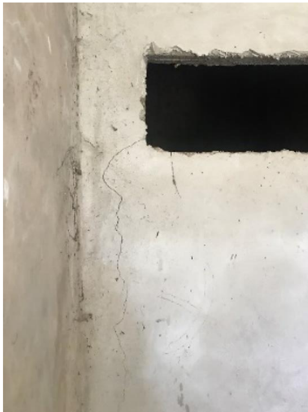
Figura 47 - Fissura em painel de alvenaria (Lado esquerdo)
