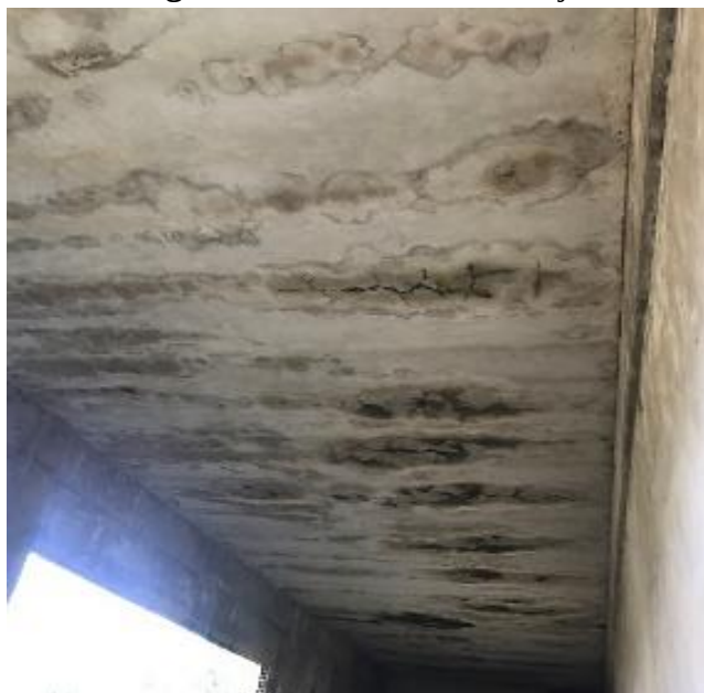
Figura 55 - Mofo/bolor em laje
