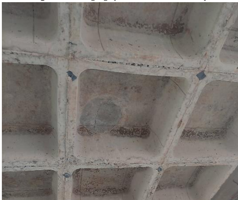
Figura 43 - Segregação e mofo/bolor em laje
