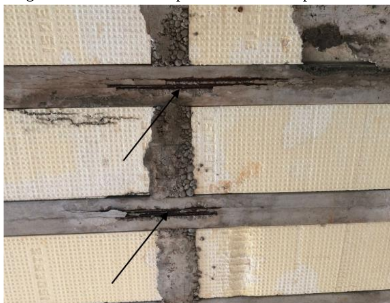
Figura 34 - Vigotas com armaduras aparentes devido ao processo de carbonatação
