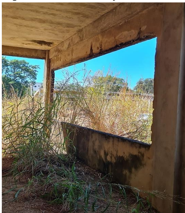
Figura 56 - Mofo/bolor em painel de alvenaria
