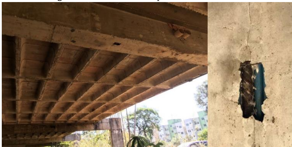
Figura 28 - Fissura com deslocamento do concreto
