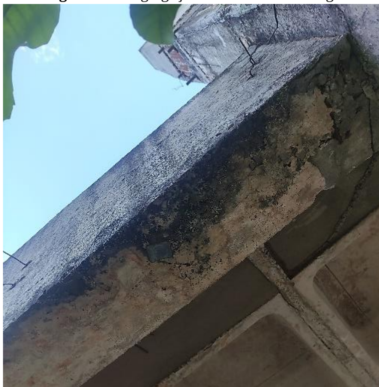
Figura 44 - Segregação e mofo/bolor em viga
