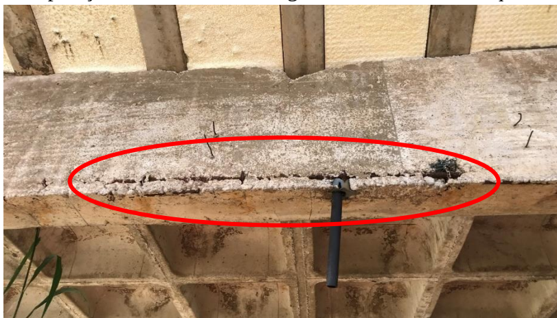
Figura 36 - Exposição de armaduras na viga com cobertura inadequada do concreto
