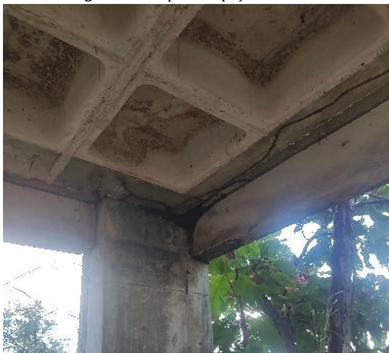
Figura 45 - Cupins em peças estruturais
