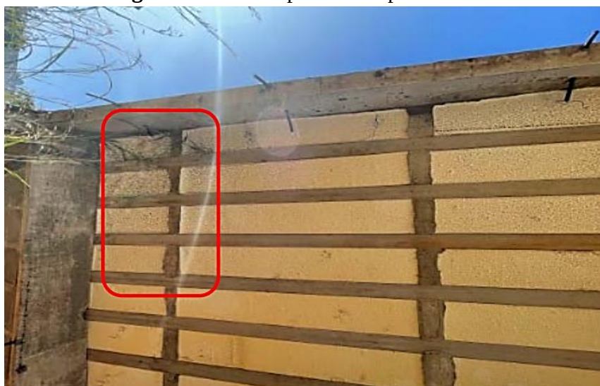
Figura 37 - Danos provocado por incêndio
