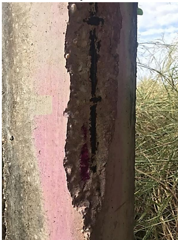
Figura 35 - Pilar com deslocamento e armadura exposta
