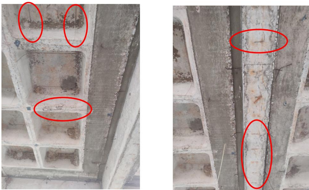
Figura 31 - Armaduras corroídas nas lajes
