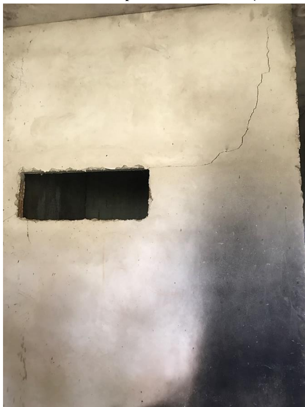
Figura 46 - Fissura em painel de alvenaria (Lado direito)
