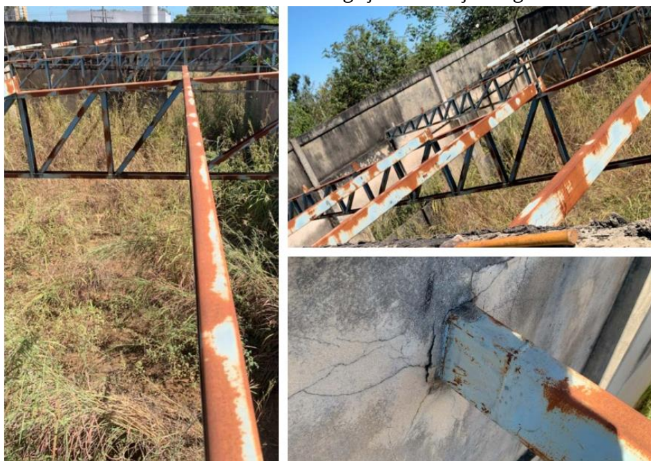
Figura 50 - Estrutura metálica oxidada e ligação das terças engastadas na alvenaria
