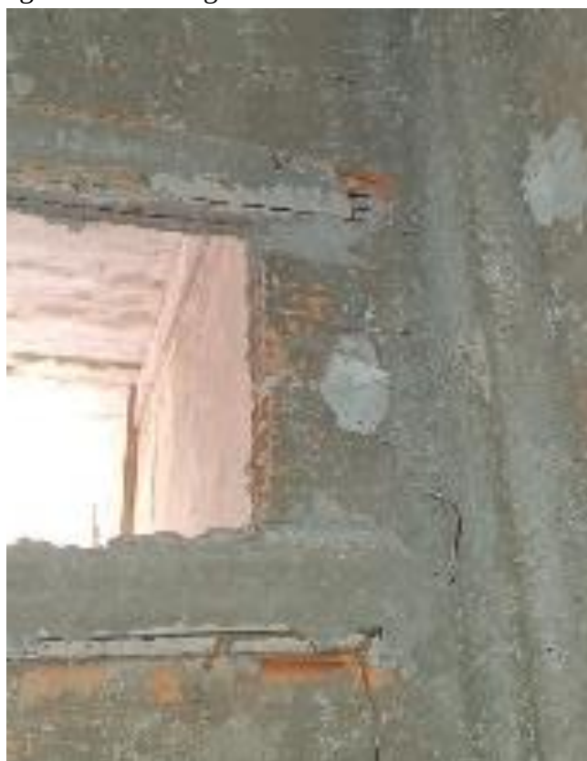
Figura 49 - Vergas e contra vergas danificadas e armaduras oxidadas e expostas
