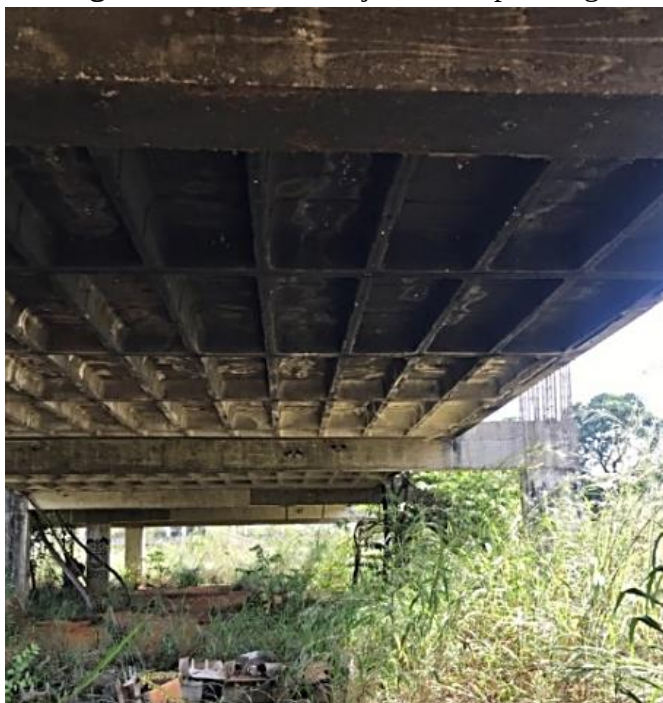
Figura 27 - Local da laje afetada pelo fogo
