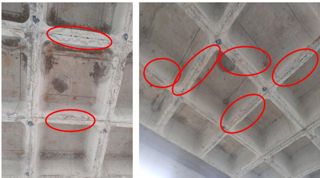
Figura 30 - Segregação nas lajes
