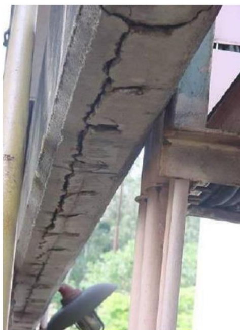
Figura 14 – Fissura em viga causada pela expansão de óxidos gerados na corrosão
