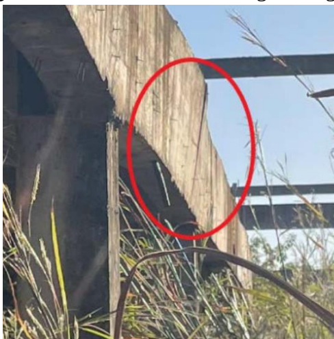
Figura 38 - Abaulamento em viga na região externa
