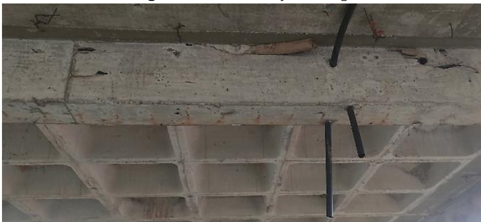
Figura 41 - Carbonatação em viga
