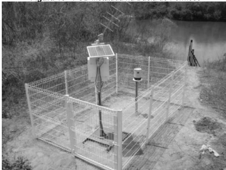
Figura 15 - PCD instalada na Bacia do Formoso
