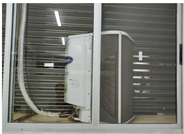
Figura 2- Condicionador de ar entre as janelas e os brises
