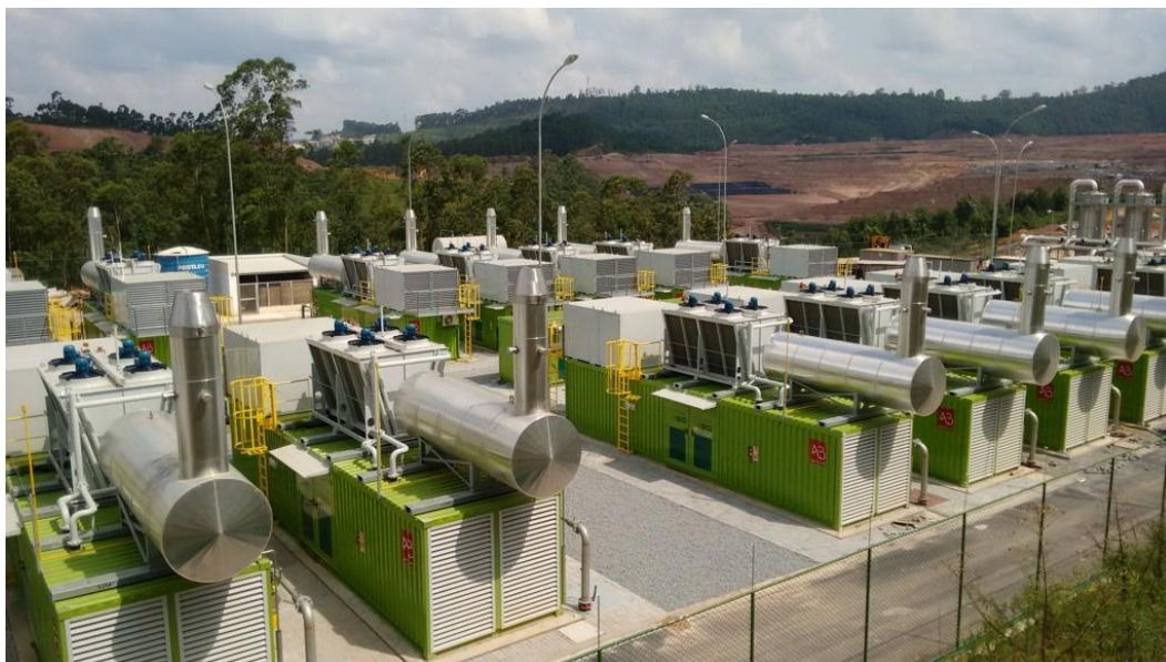
Figura 8: Usina geradora de energia através de biogás no Aterro de Caieiras.
