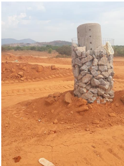
Figura 14: Drenos de biogás
