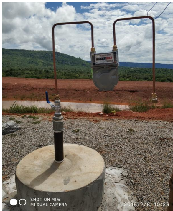
Figura 17: Medidor de vazão de biogás no Aterro Sanitário de Palmas – Tocantins.
