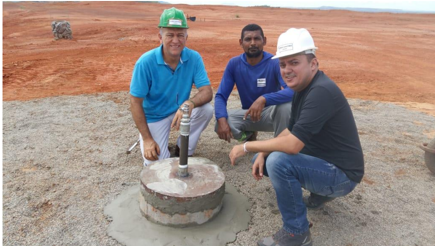
Figura 16: Adaptação dos drenos para aplicação do medidor.
