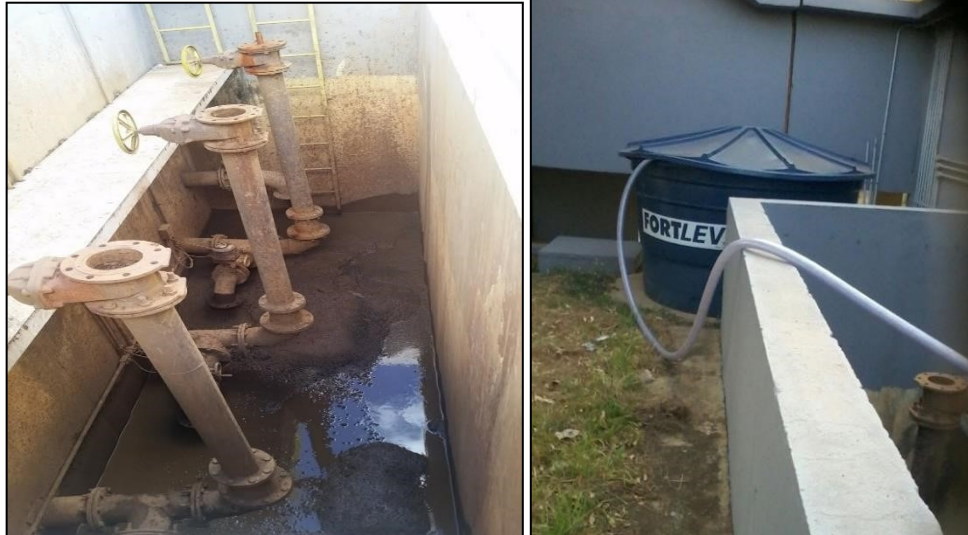
Figura 16 - Coleta do resíduo pela tubulação de descarga do decantador
