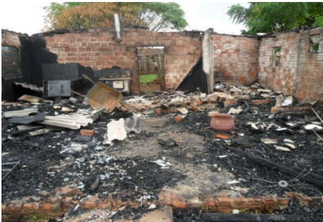
Figura 4 – Creche Casinha de Emília após incêndio
