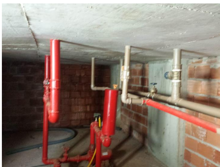
Figura 26 – Vista geral do barrilete do reservatório elevado biblioteca
