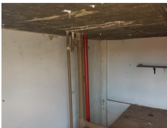
Figura 13 – Tubulações de saída reservatório elevado, laje superior
