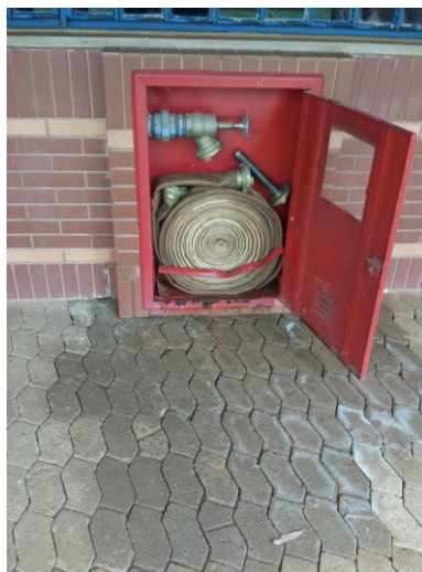
Figura 37 – Vazamento no abrigo da mangueira de incêndio
