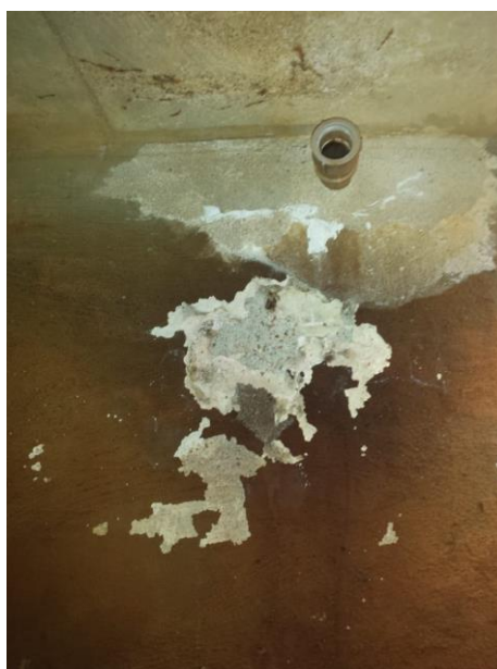
Figura 19 – Desplacamento do revestimento reservatório enterrado
