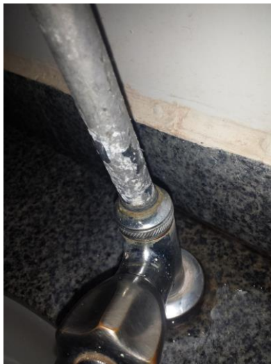
Figura 33 – Vazamento na rosca de travamento
