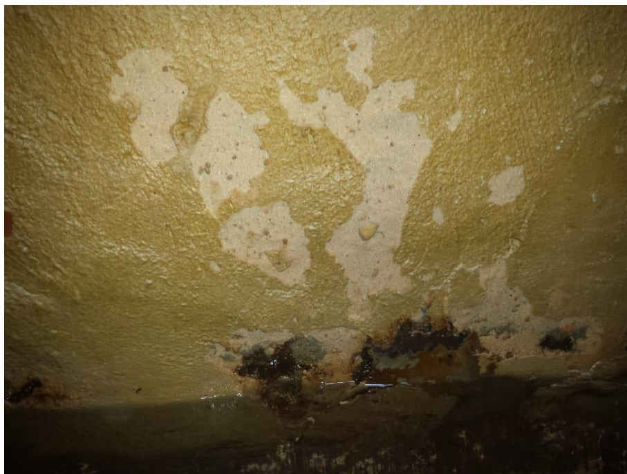
Figura 20 – Patologia na parede lateral esquerda do reservatório enterrado
