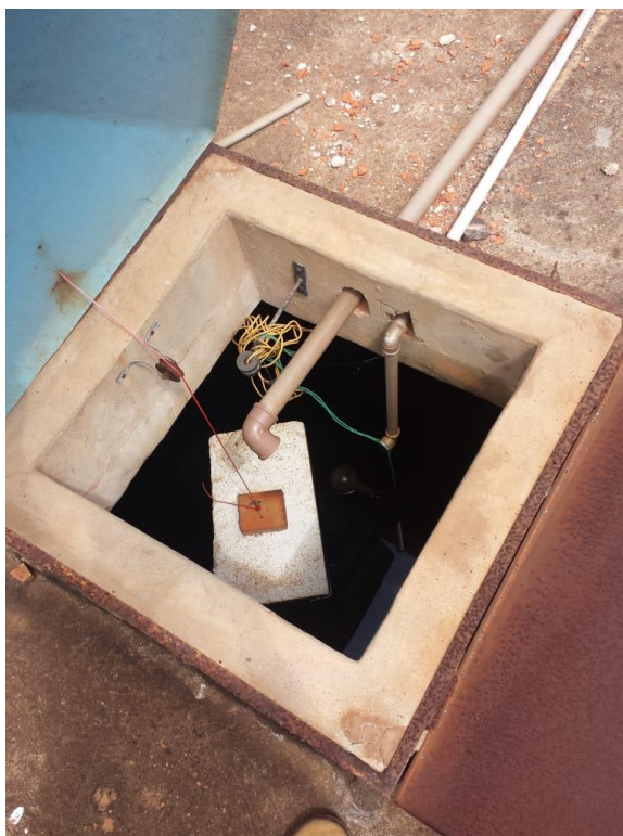
Figura 16 – Boia e sistema de automação da bomba reservatório elevado, nível laje de cobertura
