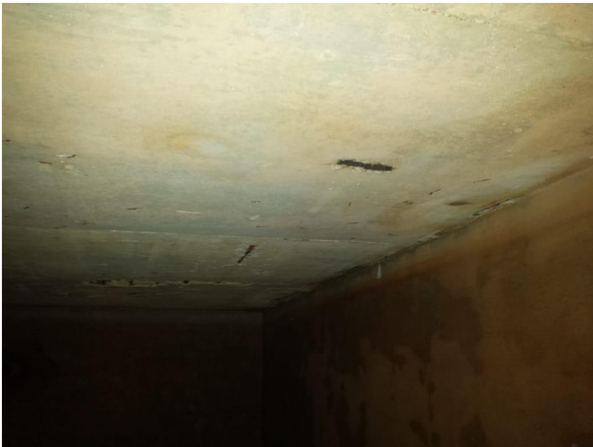
Figura 22 – Patologias na parede superior do reservatório enterrado
