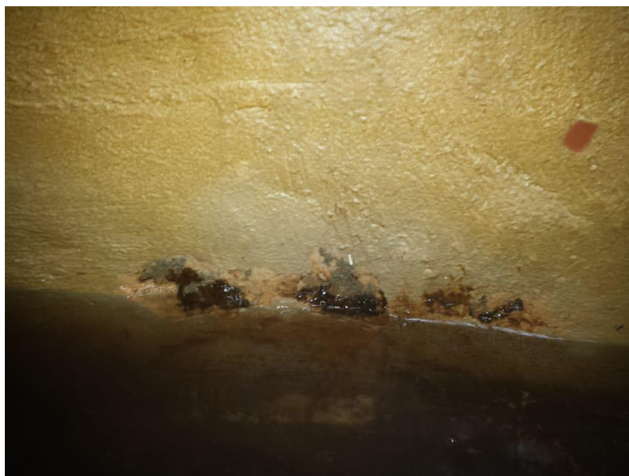
Figura 21 – Patologia na parede lateral direita do reservatório enterrado
