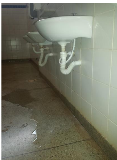
Figura 32 – Vazamento na mangueira de ligação
