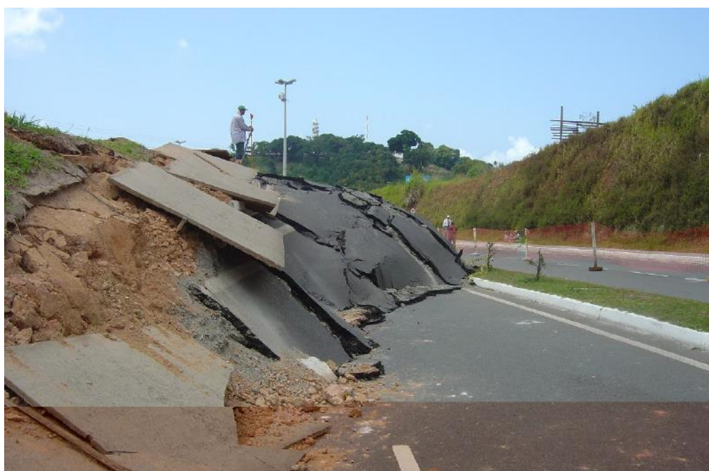
Figura 1 - Ruptura de talude rodoviário.
