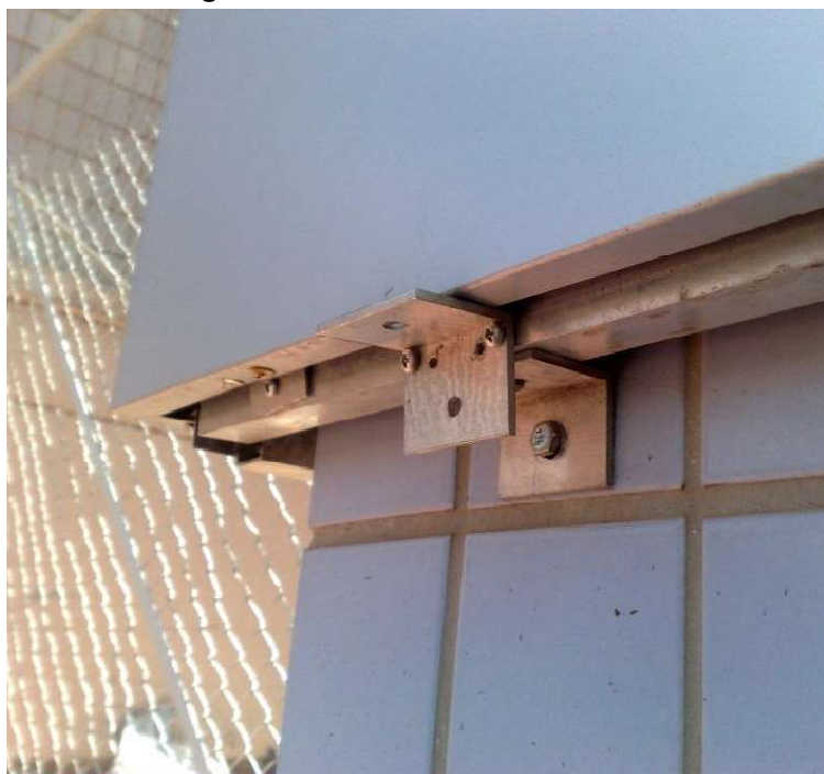
Figura 14 - Detalhe do RNA em ACM
