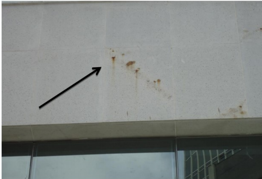
Figura 6 - Oxidação na placa de rocha
