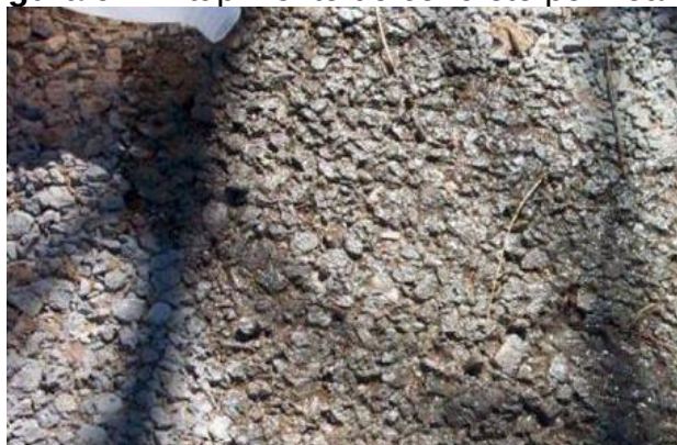
Figura 9 - Entupimento do concreto permeável.
