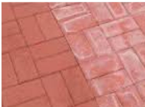
Figura 1: Eflorescência em blocos intertravados
