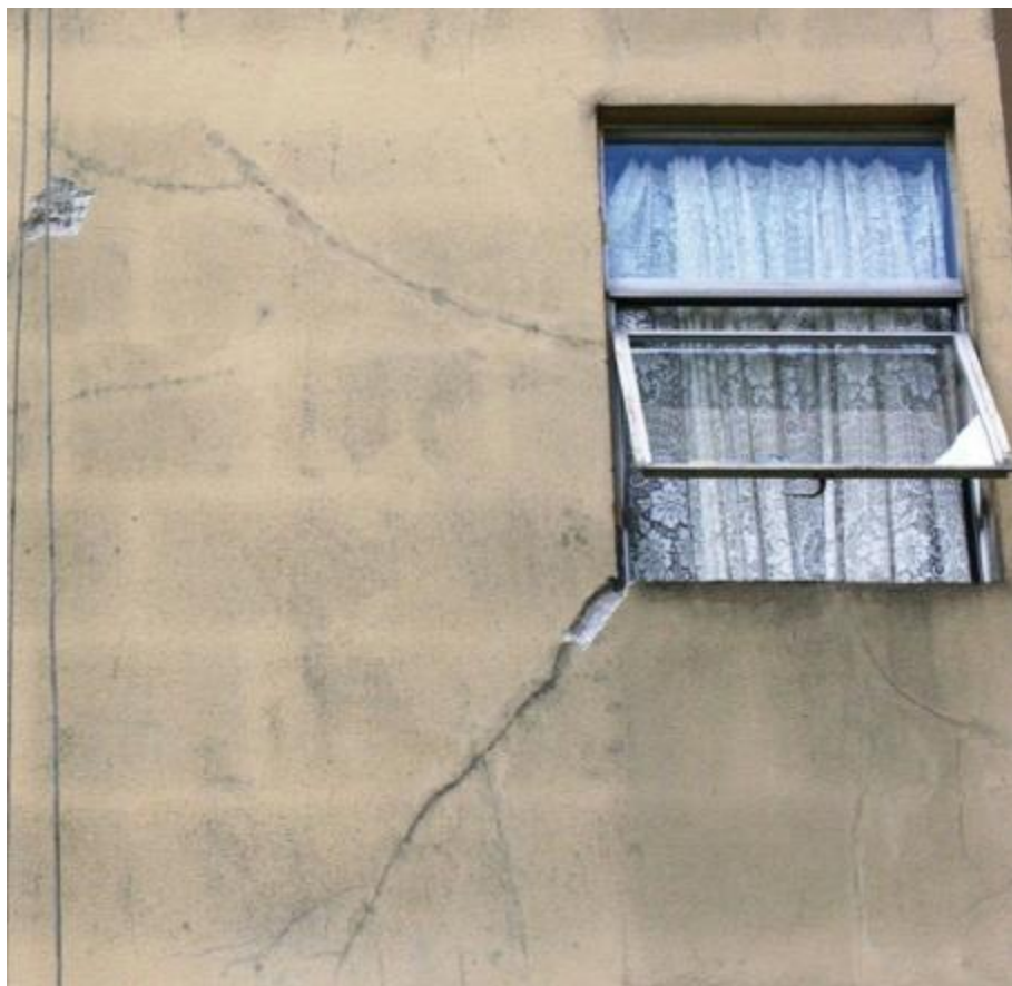
Figura 13: Fissura no canto inferior da fachada devido a falha nas dimensões de contra-verga.
