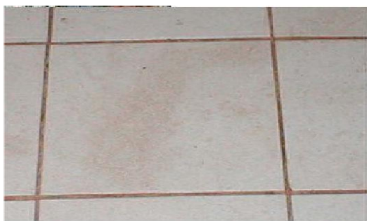
Figura 9: Manchas em revestimento cerâmico
