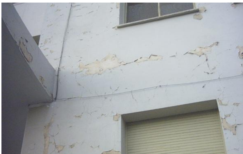
Figura 11: Desprendimento de película de pintura
