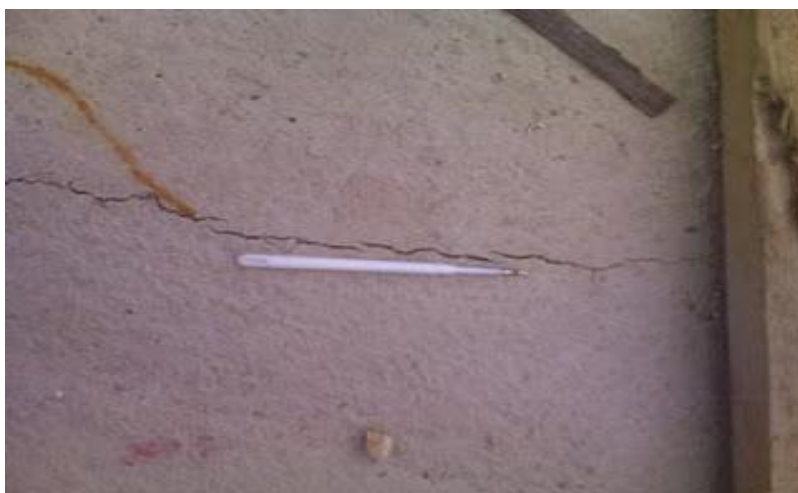
Figura 6: Fissuras de retração por secagem no reboco
